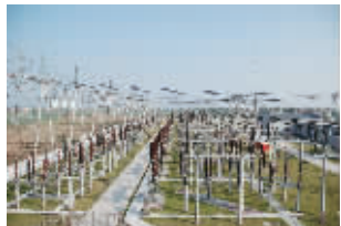
公司电网建设硕果累累，取得大丰收——220千伏东新变电所一角掠影
