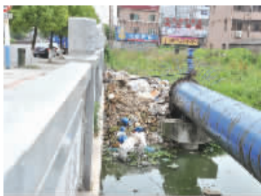
塘下大道振兴大桥下的垃圾死角
