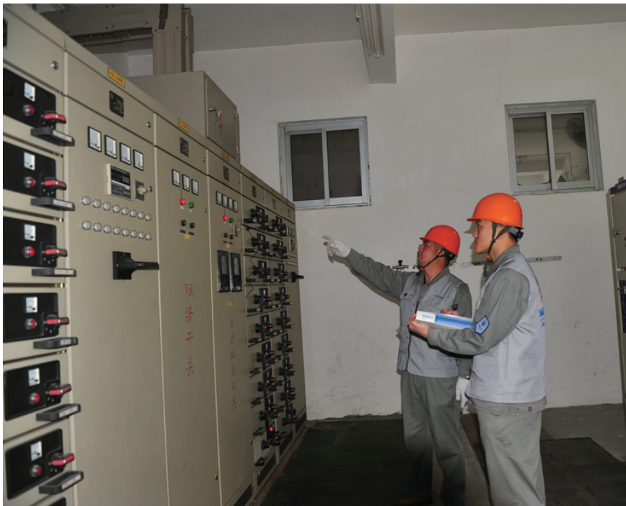
供电局员工检查社区配电房,确保用电安全。
