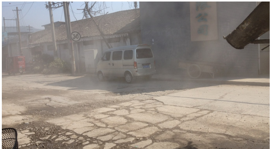
沿江西路84号附近坑洼的路面
