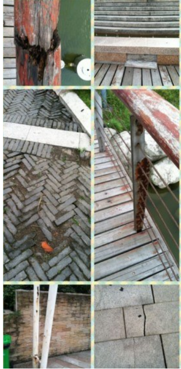
万松广场上公共设施损坏
