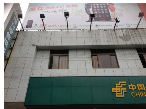
邮政大楼邮政营业厅外墙,外墙漆脱落,露出里头的瓷砖。
