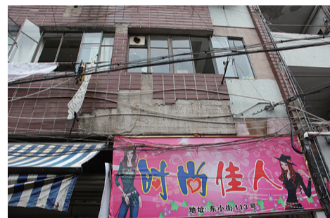
东小街7幢楼墙体,红色瓷砖大面积脱落。
