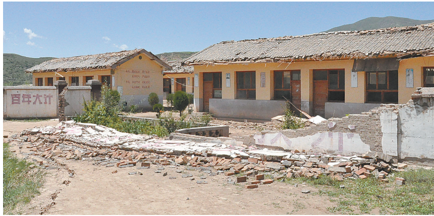
甘肃省岷县马家沟村一学校受损
