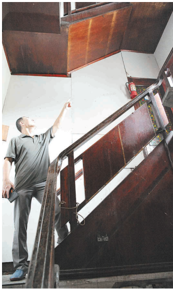
通道全部为木质楼梯,存在安全隐患
