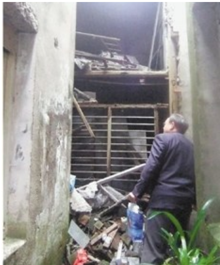
王强家的一侧墙面已坍塌 ,随时有危及邻居房屋的可能。
