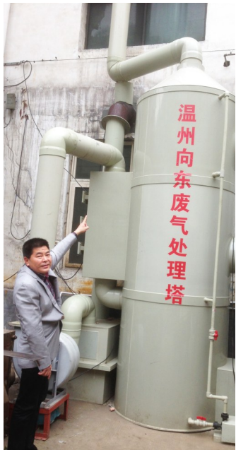
林巧荣介绍废弃处理塔的运行原理
