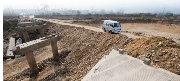
潮鹿大桥仍未修复 村民出行不便
