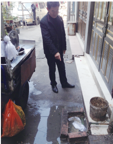
污水从堵塞的排污口溢出
