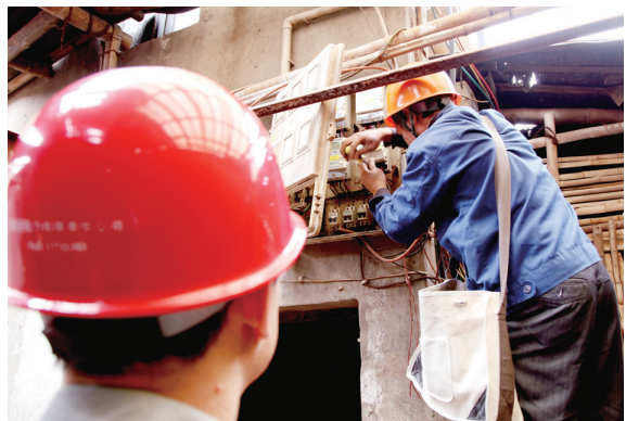
近日,鲍田办事处继续开展“雷霆一号”行动。据了解,经过4次专项打击,该办事处已对30多家涉水污染企业采取停电停水措施,下一步,将拆除这些污染企业的违章厂房。
