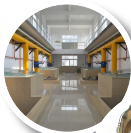
江北水厂滤池
