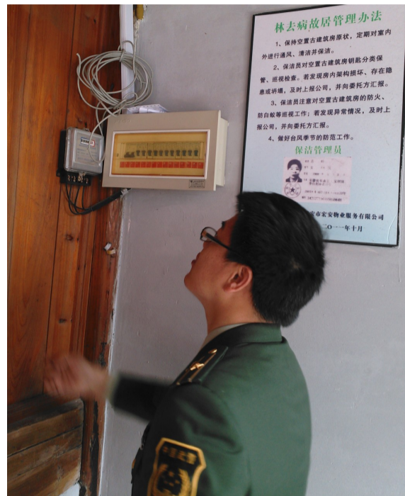
林去病故居,电表直接装在木墙板上
