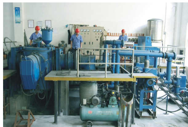
“振兴石化”生产车间
