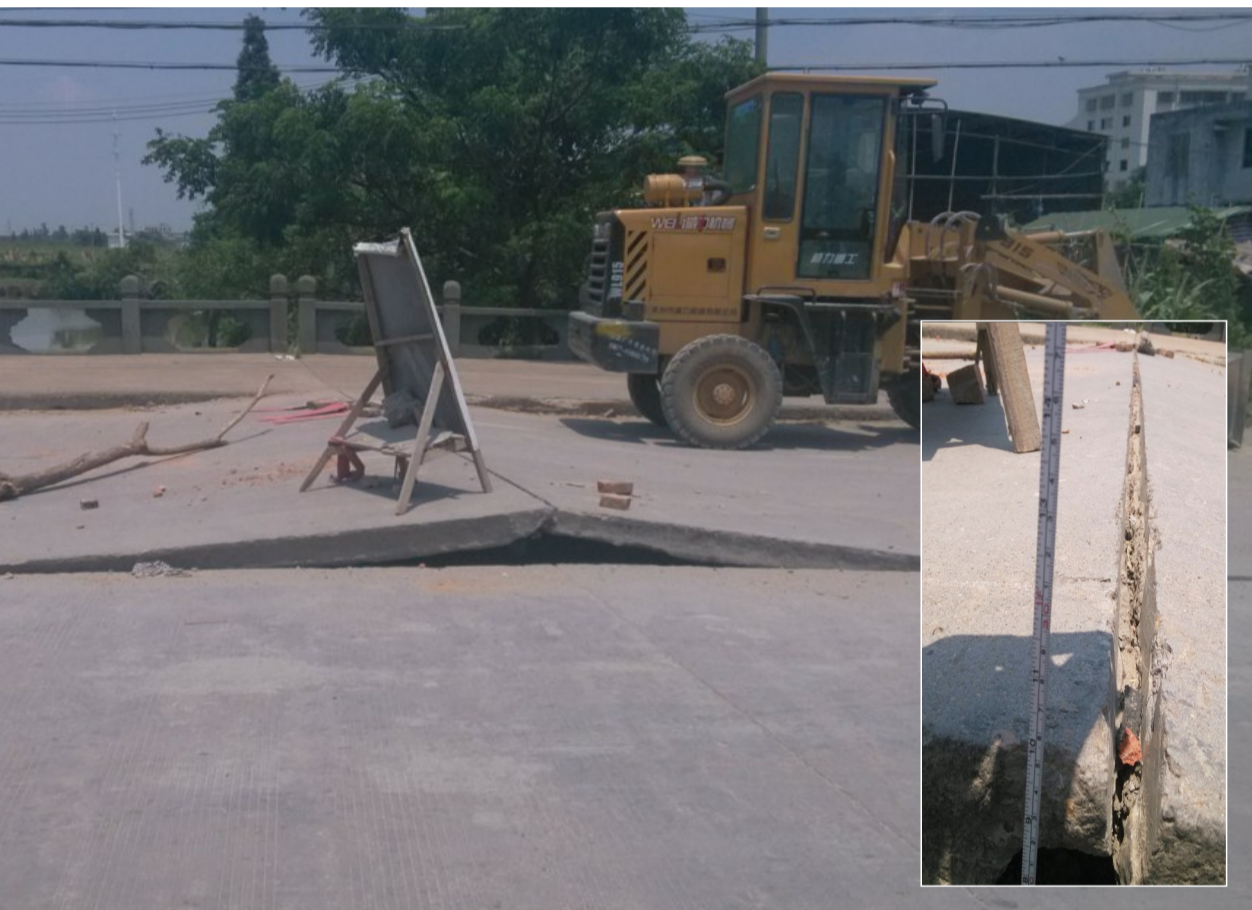
桥面拱起，裂缝较大
