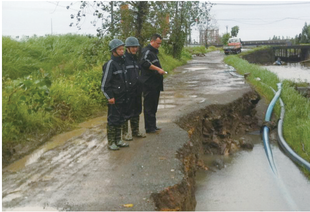
鲍田办事处主要领导查看鲍六沥鲍垟段河岸坍塌现场
