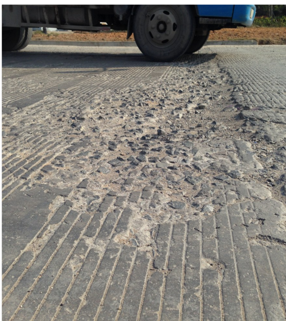
水泥路面坑洼不平
