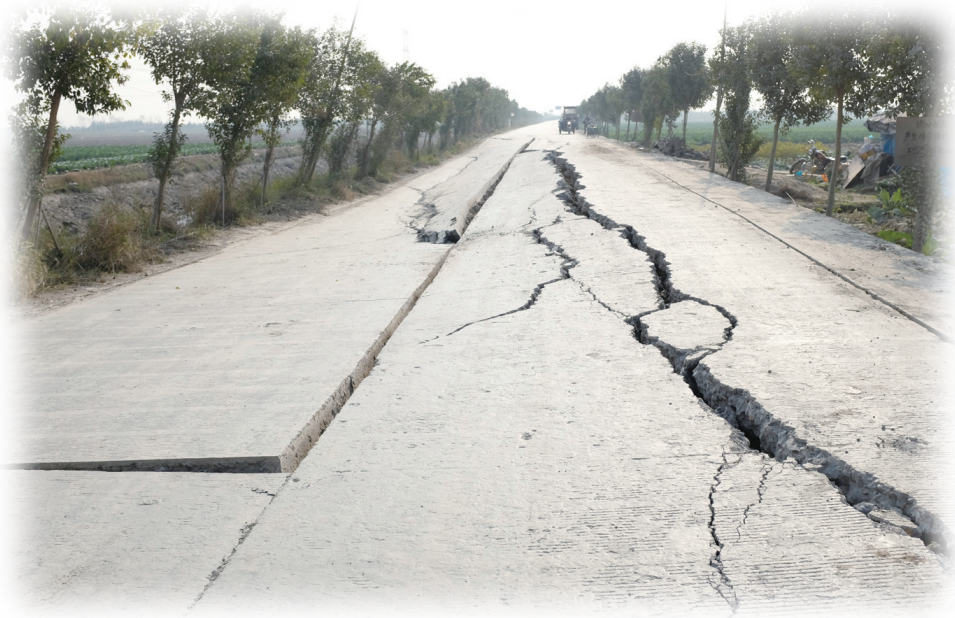
前池路道路塌陷
