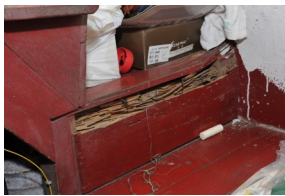
谢先生家的楼梯被白蚁啃噬严重
