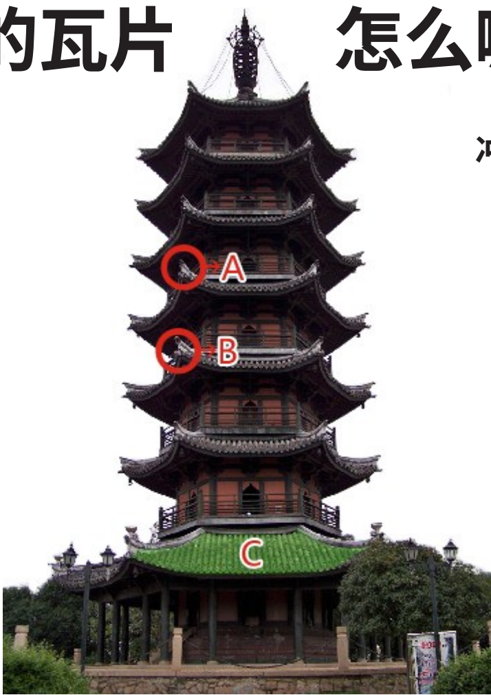
图中A、B处的飞檐破损最严重，C处檐面上的瓦片破损较多
