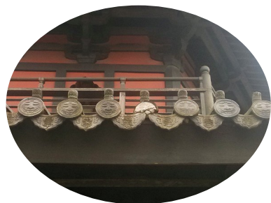
部分瓦当已损坏
