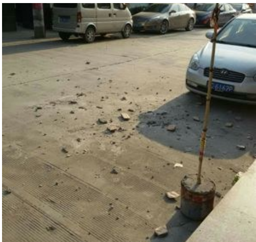
路面散落一大片外墙面砖
