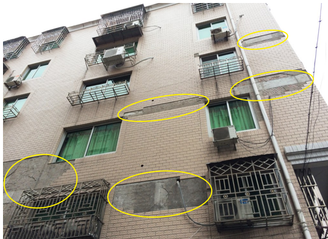
外墙瓷砖成片脱落
