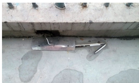
南面看台裸露的电线
