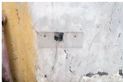
东面看台裸露的电线
