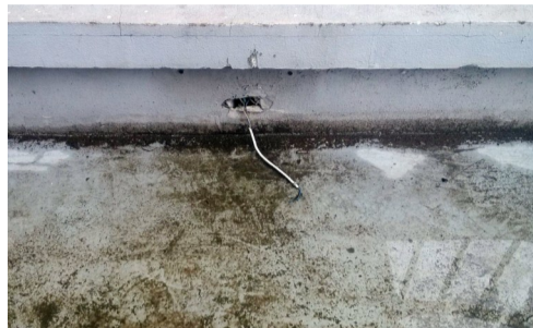
北面看台裸露的电线
