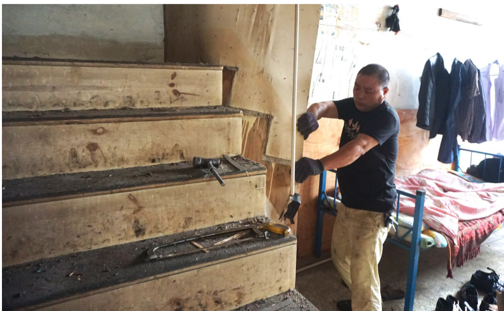
霞林村一房东自拆木隔断
