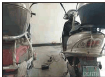
未设置安全充电设施
