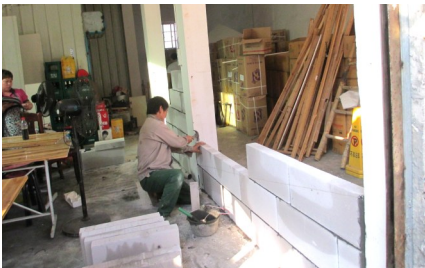
官渎村一合用场所采取砖墙隔断
