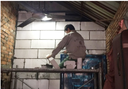
官渎村消防安全整改中
