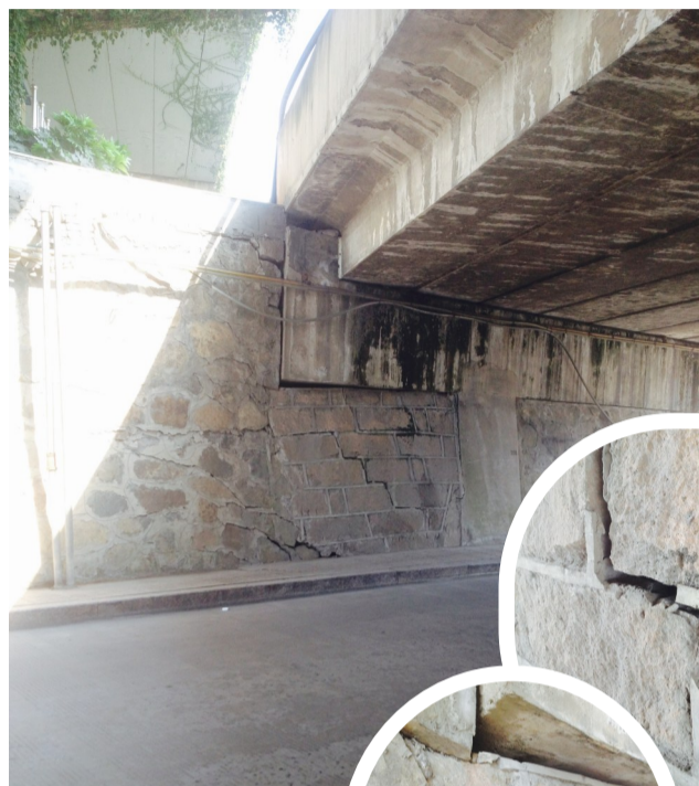
高架桥下的挡土墙出现多处裂缝
