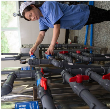
蓄水池里的水进入精密过滤系统
