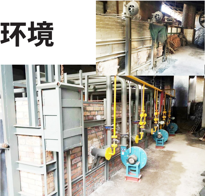
塘下一企业改造前后的锅炉(资料图片)
