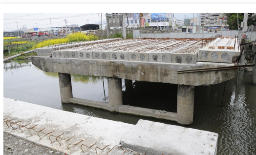
汀田邮电中路停工的桥梁
