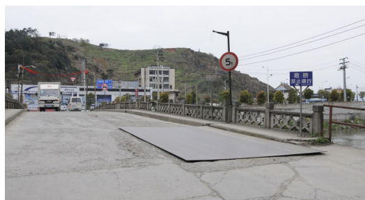
破损的岑岐桥
