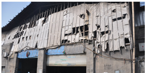
一家锻造厂墙壁破烂安全隐患明显
