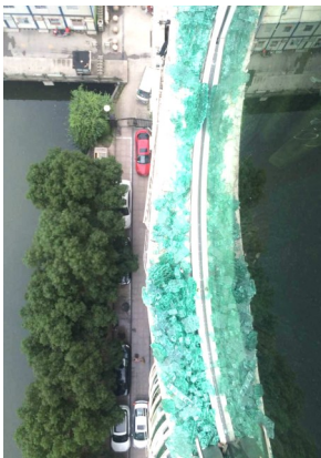
破碎的外墙钢化玻璃
