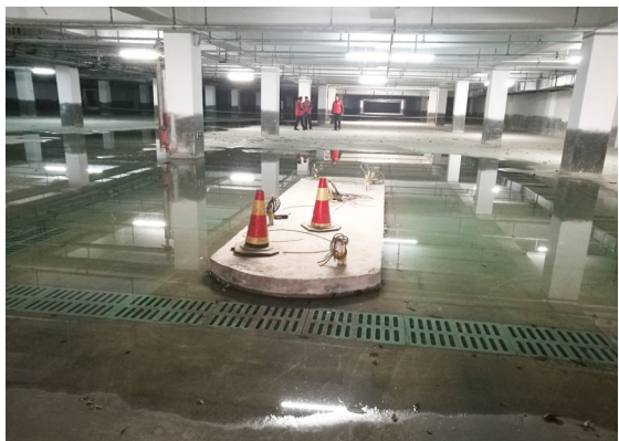
地下停车场内积水严重
