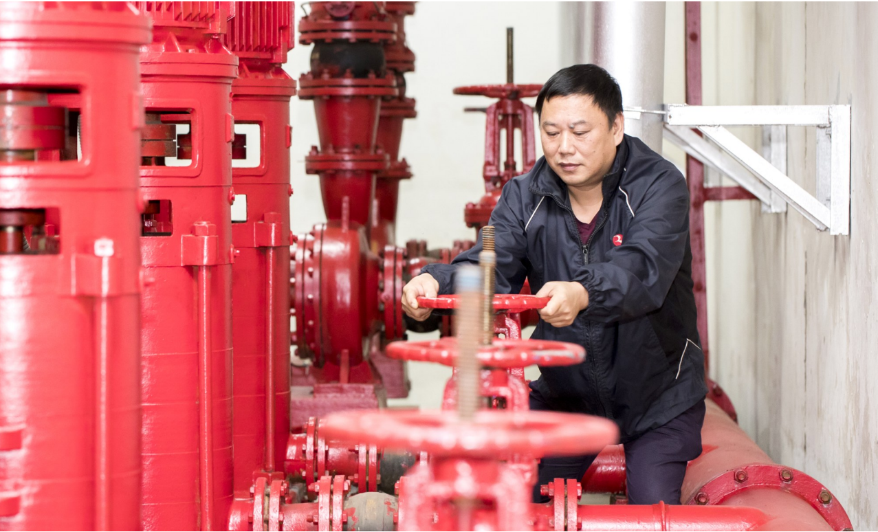
王海风在泵房检查设备
