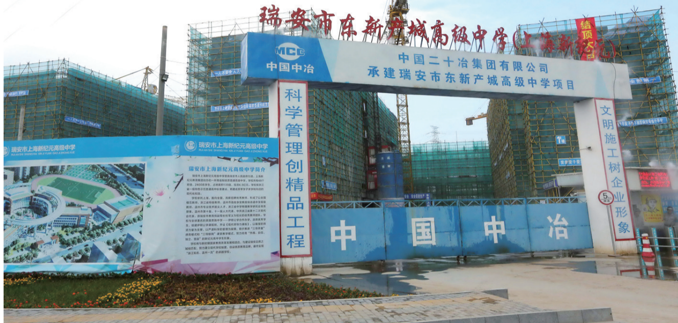
目前,在东新城融合示范带,瑞安市上海新纪元高级中学项目多幢大楼已封顶,正加紧建设,室内室外同时施工,计划9月投入使用。该校为48班寄宿制高级中学,占地139亩,总建筑面积约9.7万平方米,总投资约3.5亿元。(记者 庄颖超)
