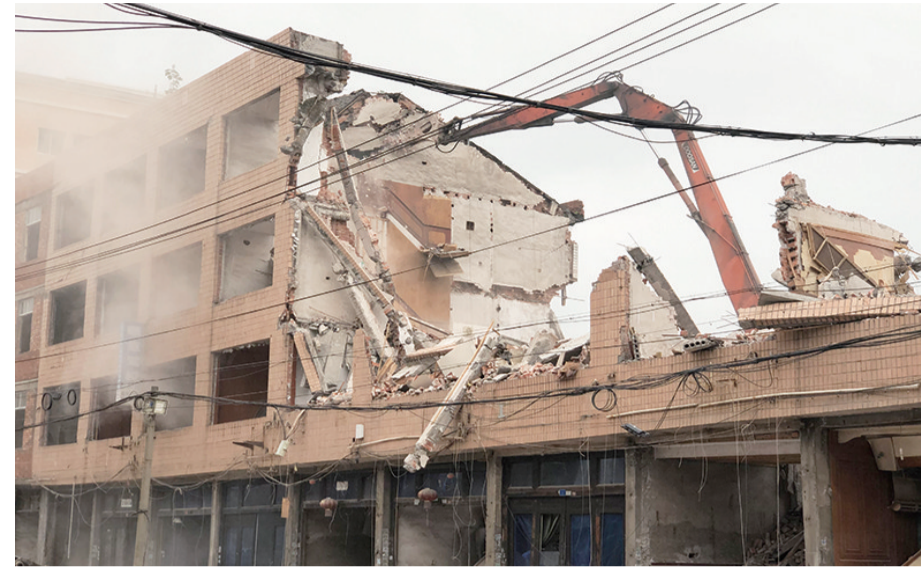
平方米,其中40间D级危旧房屋纳入整改范围并顺利拆除。塘下住建局副局长张德涵表示,下一步将继续加大对辖区内
