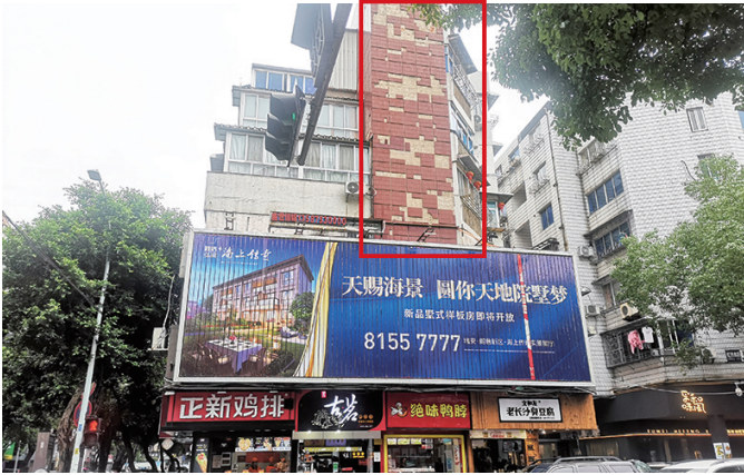
多处外墙砖脱落
