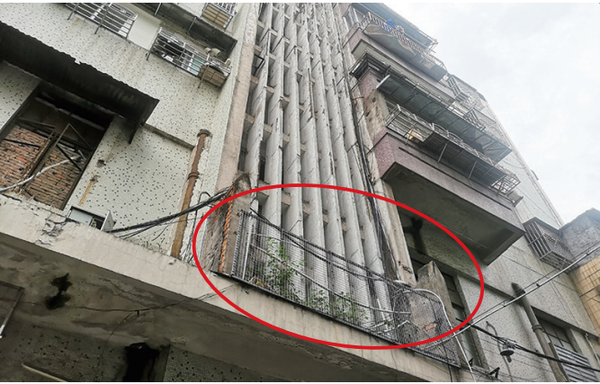
水泥装饰条脱落，居民做了简易防护
