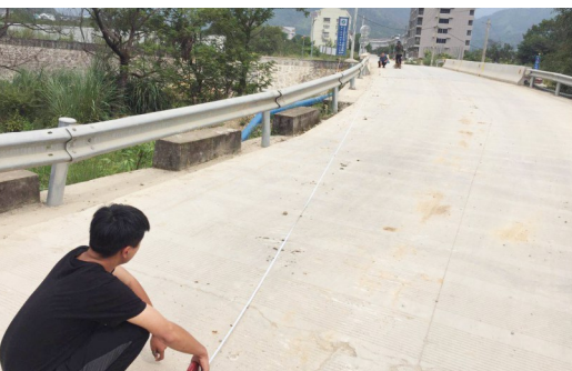
执法人员测量损坏的路面
