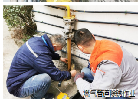
燃气管道无泄漏检测
