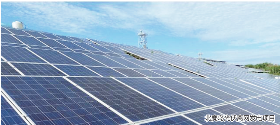
北麂岛光伏离网发电项目
