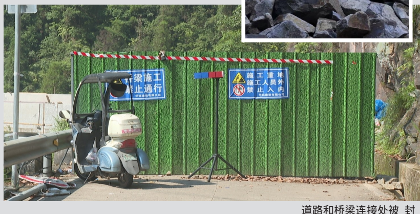
道路和桥梁连接处被“封”
