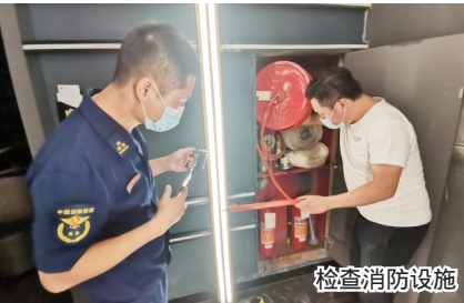
检查消防设施
