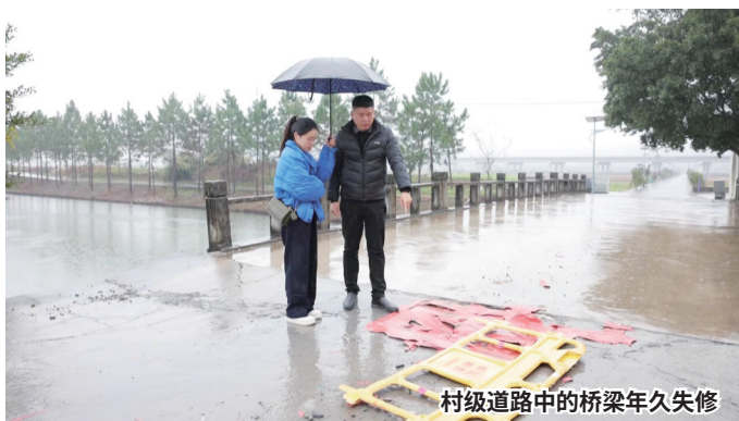
村级道路中的桥梁年久失修
