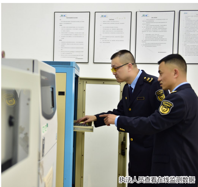
执法人员检查(VOCs)治理设施
