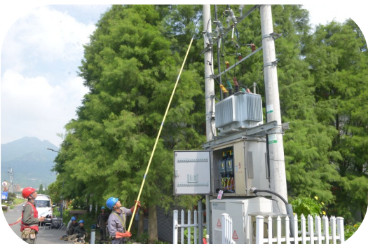
国内首台配网智能有载无级调压变压器投运
