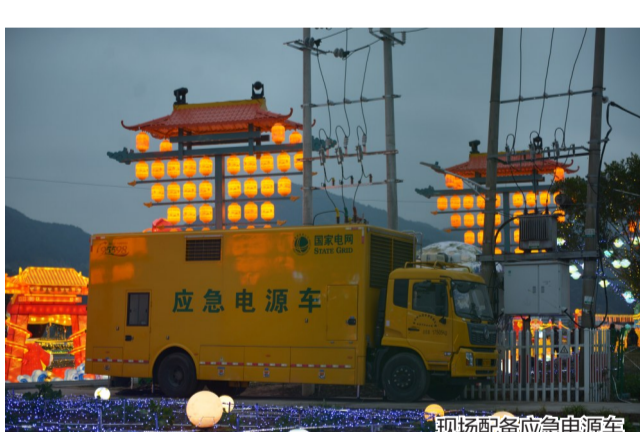
现场配备应急电源车
