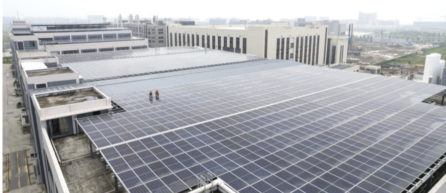
供电公司员工对企业屋顶光伏进行运维(陈辰洲/摄)
