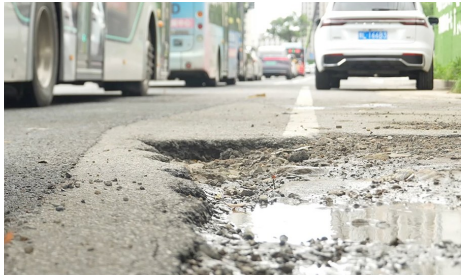
路上的坑洞存在严重安全隐患
