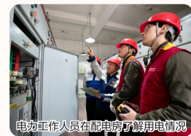
电力工作人员在配电房了解用电情况
